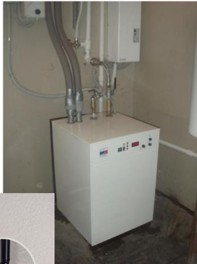
Площадь котельной 2 кв.м.
