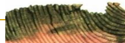
Наружная трухлявая гниль
