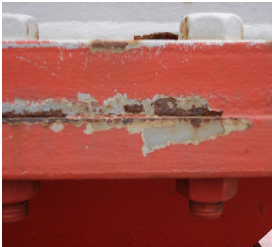
Стыки, фланцы, сварные швы
