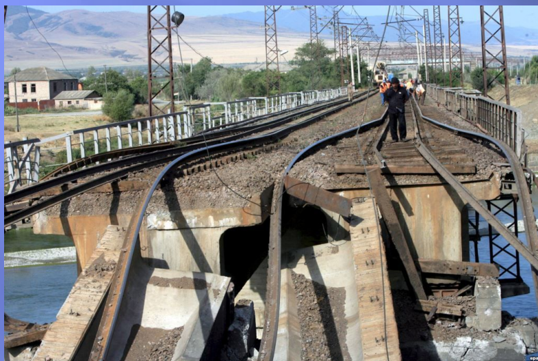
Остатки железнодорожного моста через р.Ингур
