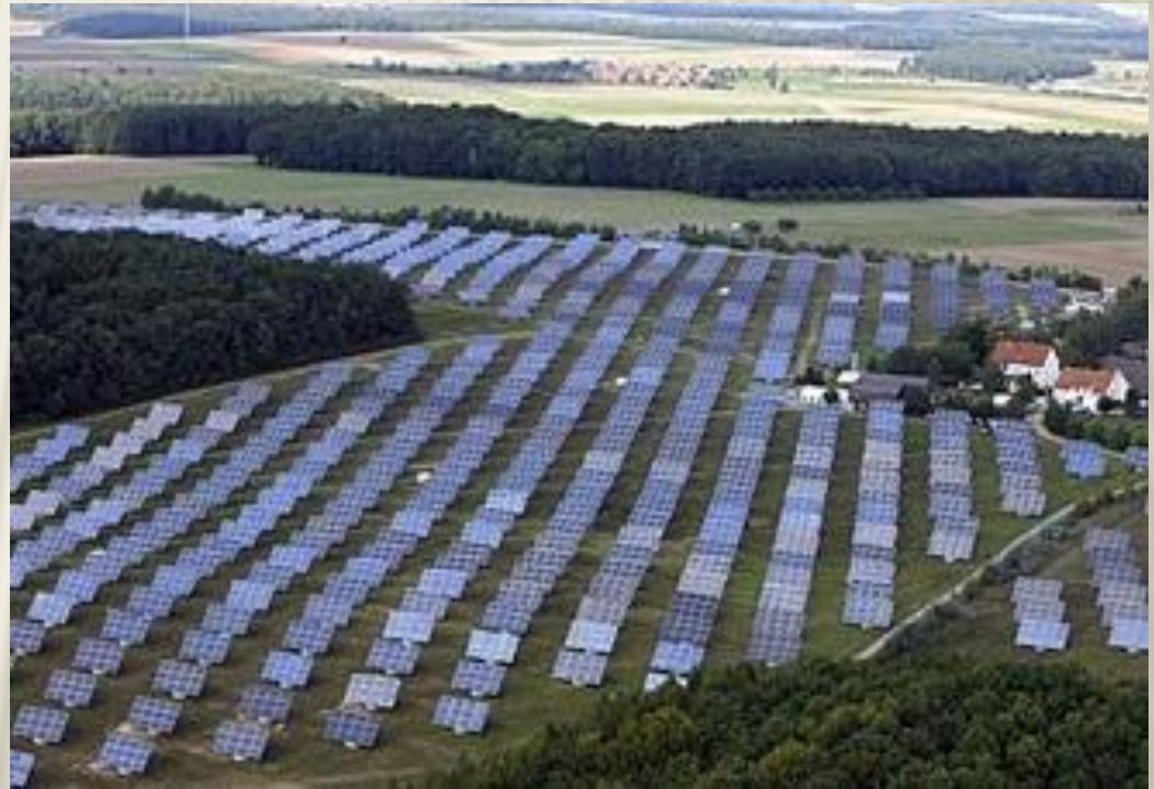
Солнечная электростанция в Германии
