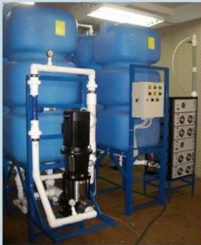
Станция озонирования для обезжелезивания воды
