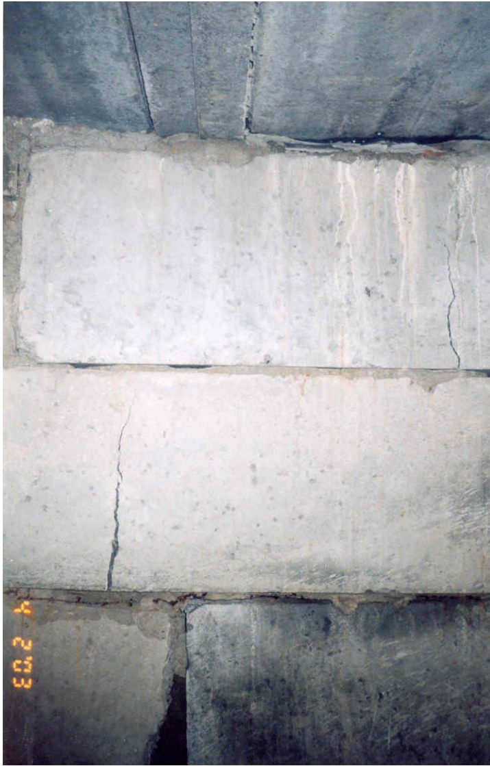
Разрушение бетонных стеновых блоков
