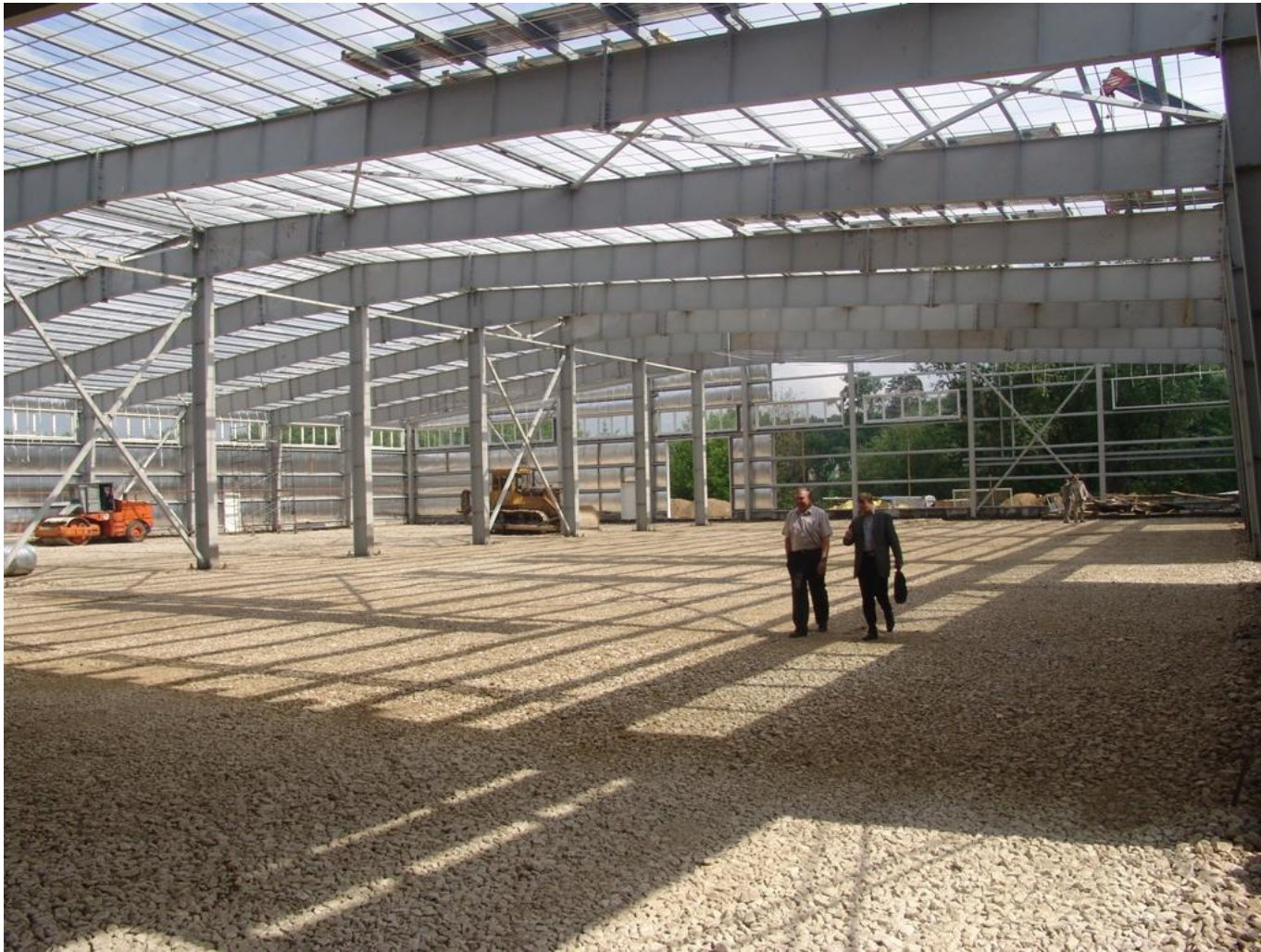
Каркас здания с двухпролетными рамами из сварных двутавров
