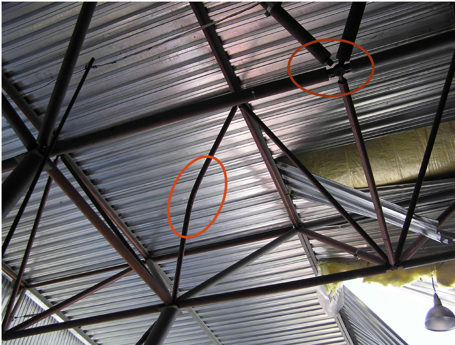
Потеря устойчивости сжатого стержня и размыкание узла сопряжения растянутого стержня решетчатого ригеля
