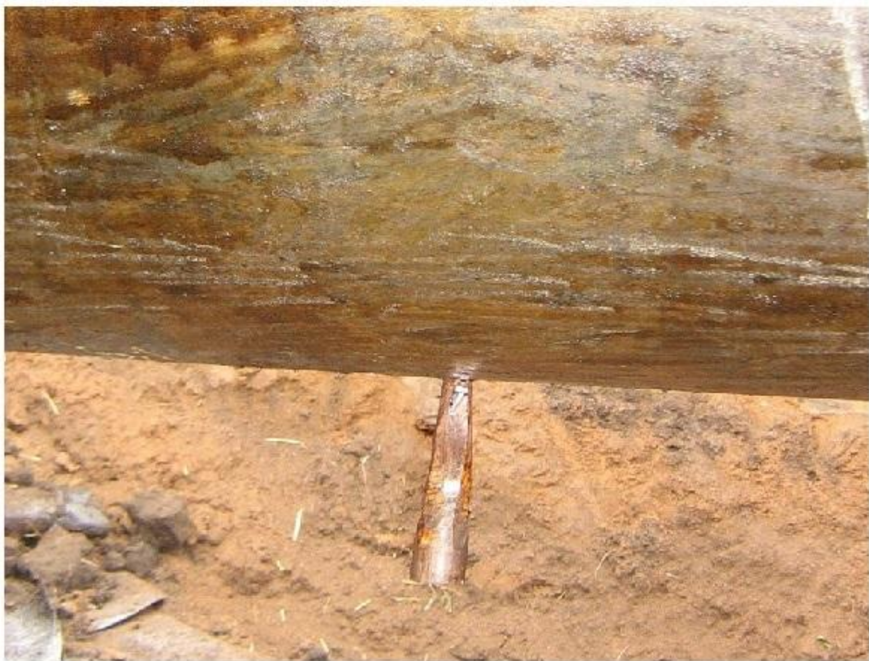
Рисунок 6 - Локализованная течь, образовавшаяся на коррозионном питтинге
