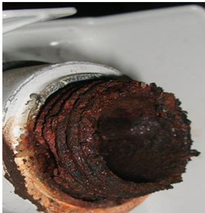
Коррозия ниппеля в обычном соединительном узле
