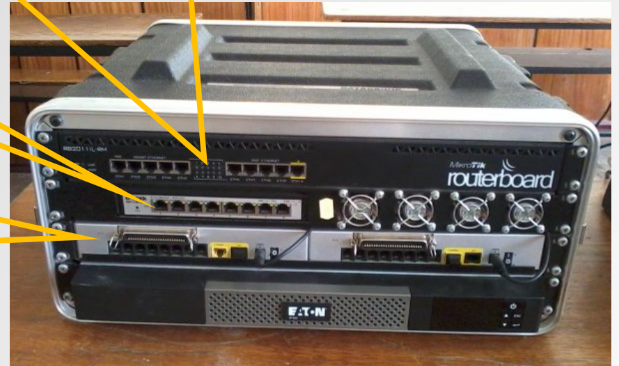
Склад телекомунікаційного обладнання СТК-1
