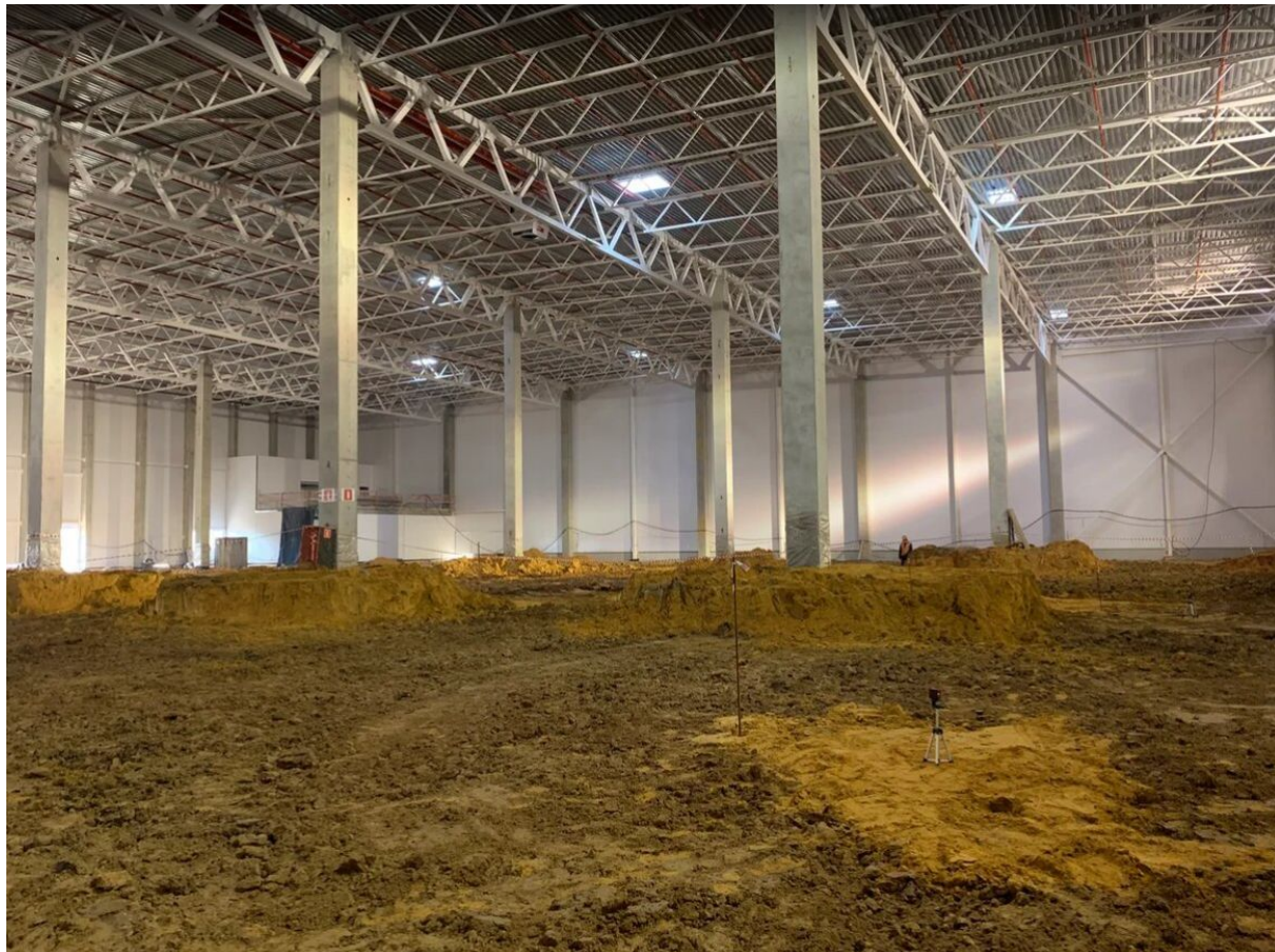
Разработка грунта под плиту пола / Excavation of soil under the floor slab
