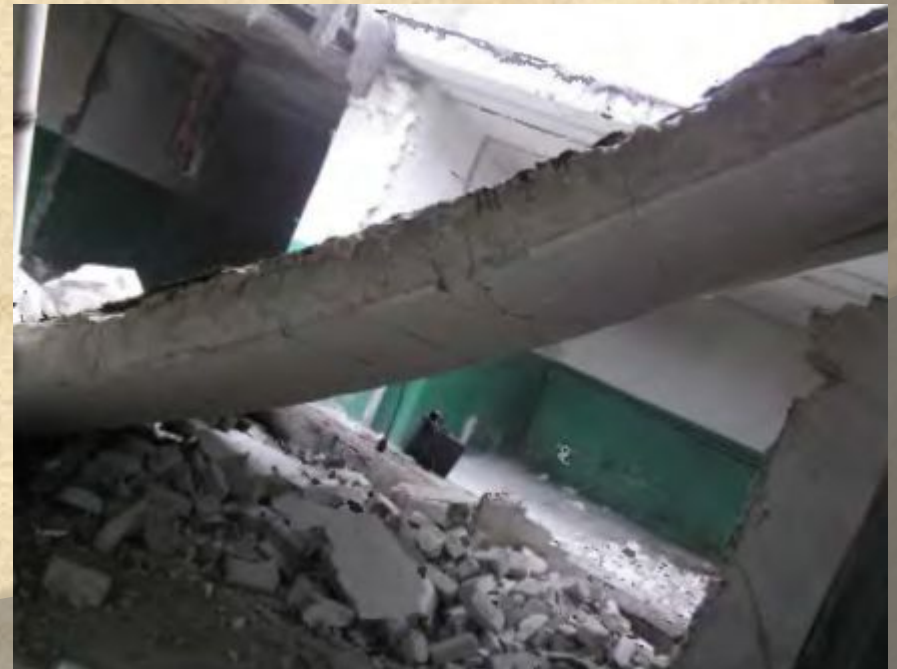
Рис. 6.2. Обрушение плиты перекрытия в результате недостаточного опирания на несущие стены
