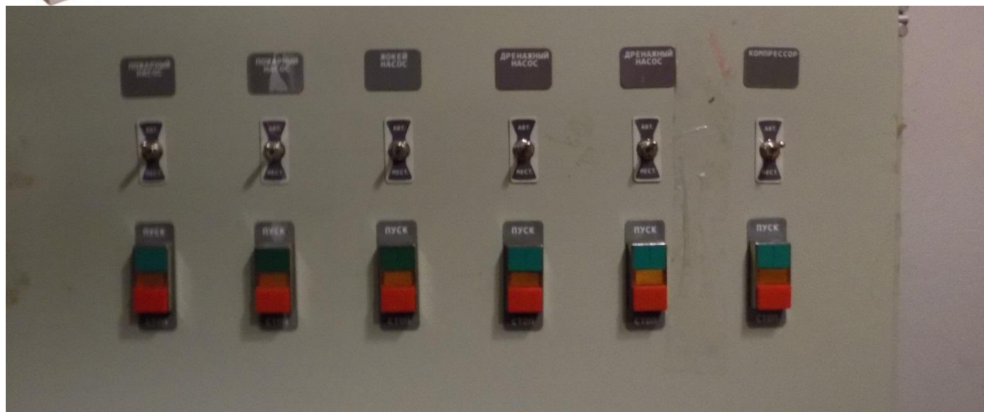
ШКАФ УПРАВЛЕНИЯ НАСОСАМИ
