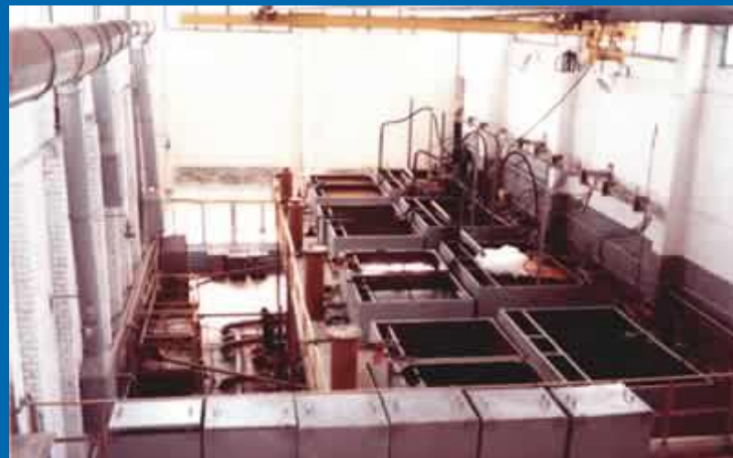
• Станция нейтрализации сточных вод
