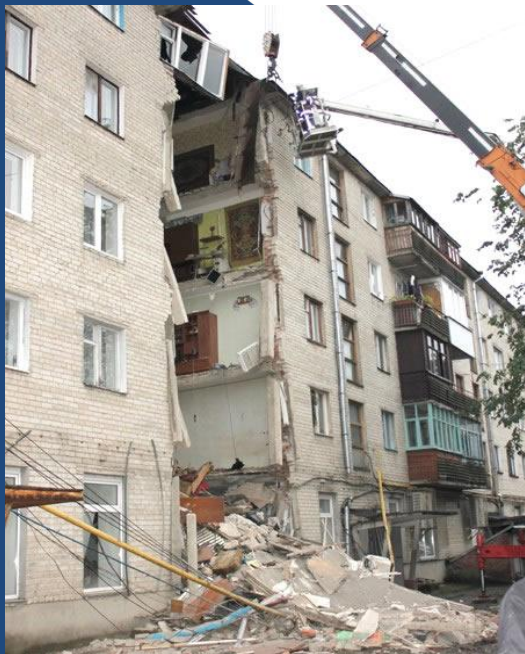
Последствия незаконной перепланировки
