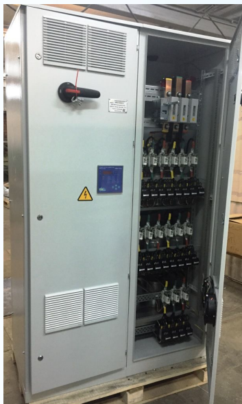
Внешний вид установки КРМ-0,4
