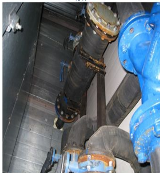
Элементы инженерных систем имеют следы протечек.
