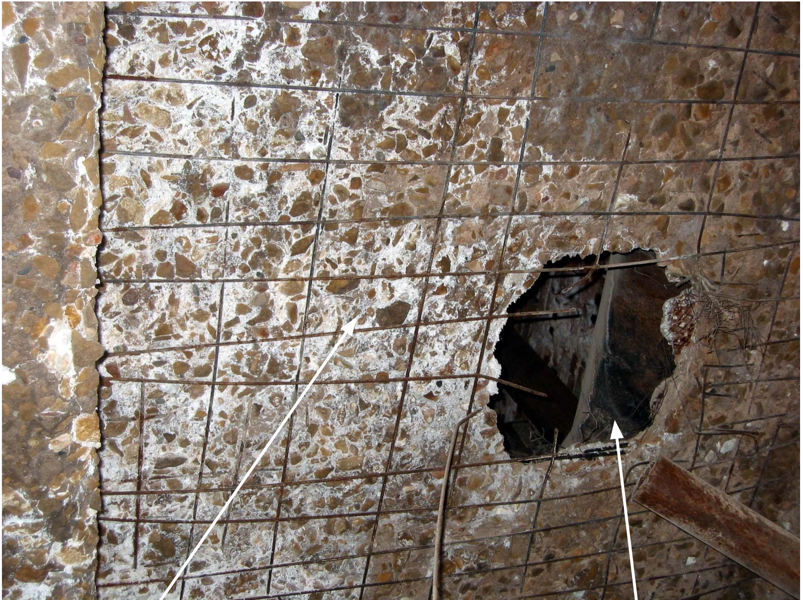
Химическая эрозия бетона. Отслоение защитного слоя бетона
