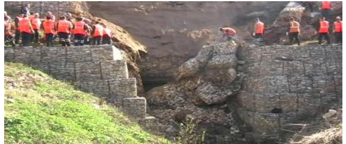
Разрушение подпорной стенки из габионов 569км С-Петербург - Москва
