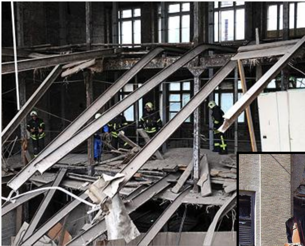
Разрушение металлического каркаса зданий
