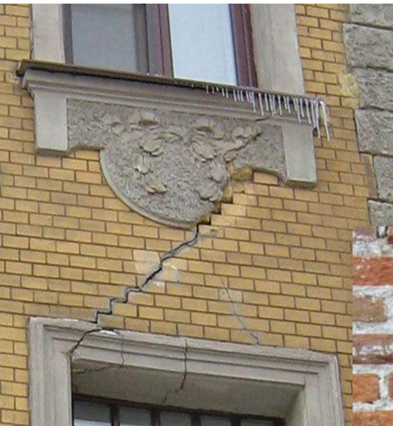
Примеры частичного разрушения кирпичной кладки
