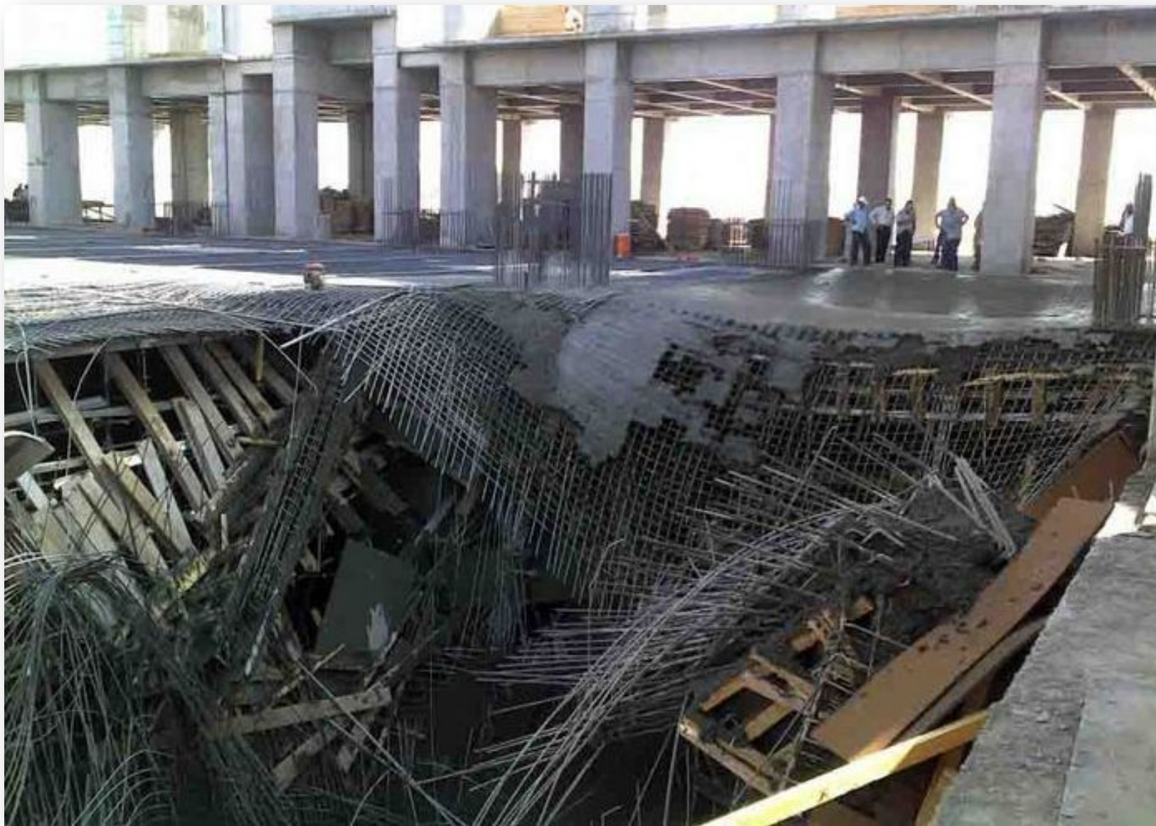
Обрушение монолитного перекрытия
