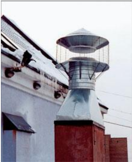
Рисунок 1. Дефлектор ДС630 на объединенном канале
