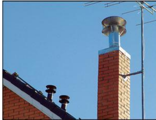
Рисунок 2. Дефлекторы АСТАТО на дымоходе и на вытяжных каналах коттеджа в Подмоскowie
