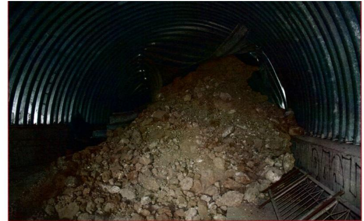
Фото 5. Вывал грунта земляного полотна внутрь арки.
