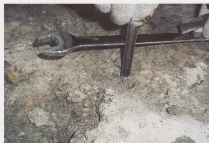
Фото 9. Замер толщины разрушенного слоя бетона.
