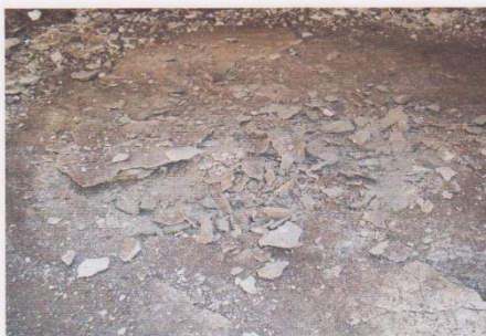
Фото 1. Разрушение поверхности бетона стяжки пола.
