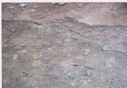
Фото 2. Разрушение (отслоение) бетона стяжки пола на глубину до 50 мм.
