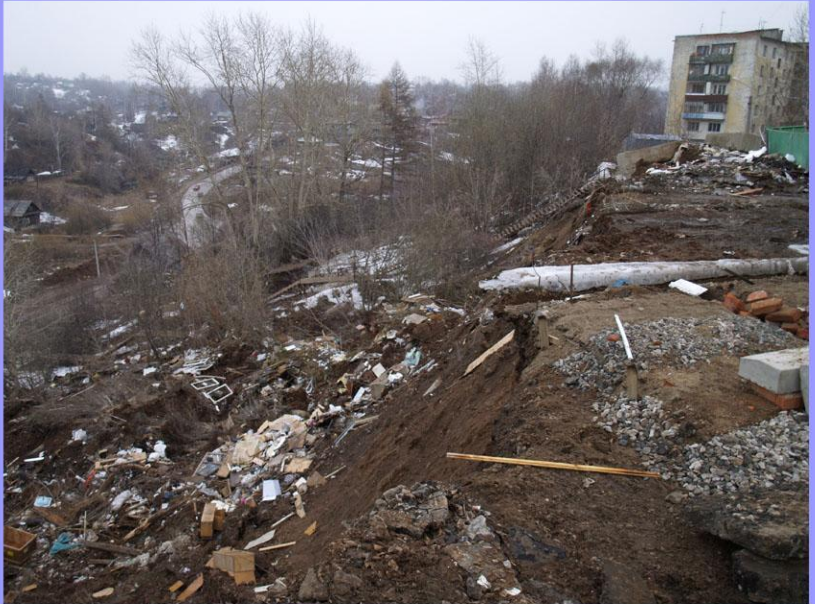
Авария склона на ул. Ким г.Пермь (апрель 2007)
