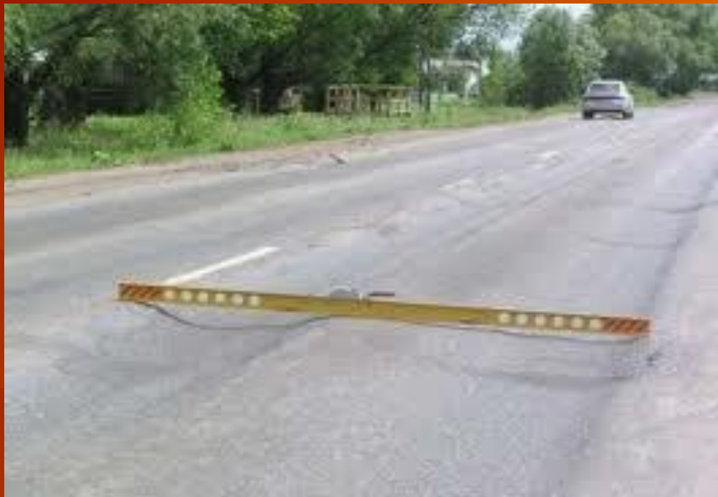
路面车辙 Дорожная колея
