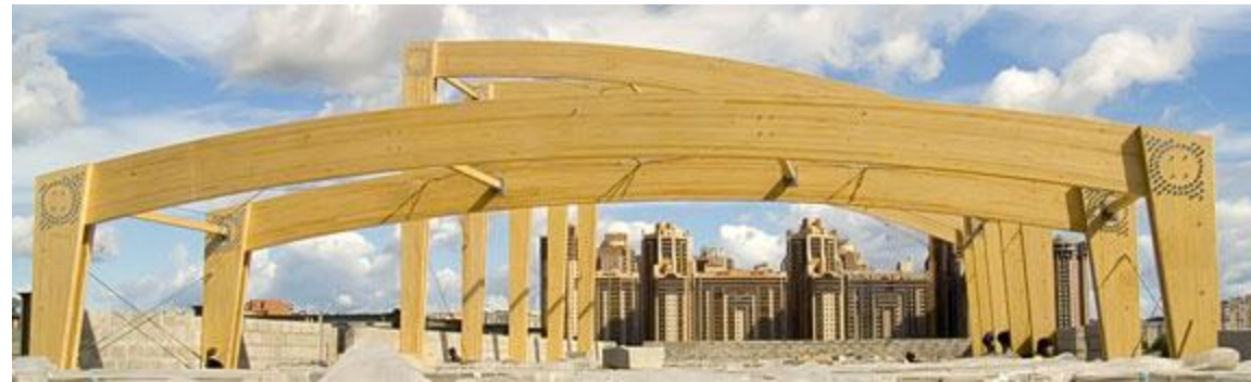
Пример двухшарнирной рамы с сопряжением стоек и ригеля на нагелях, расставленных по окружности.
