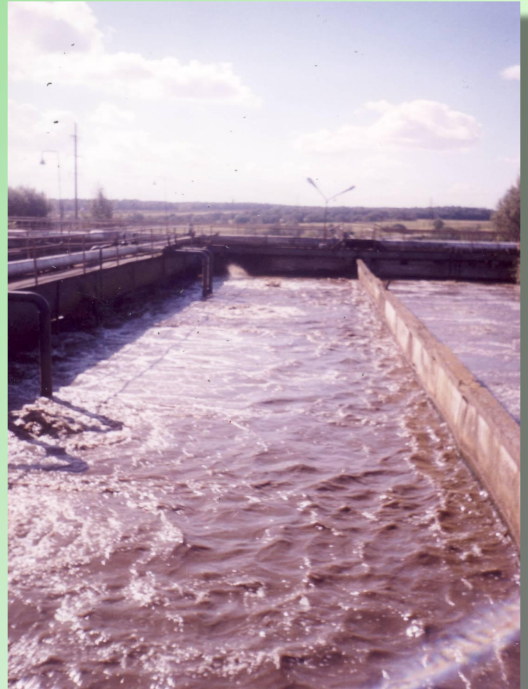
Резервуары для очистки воды
