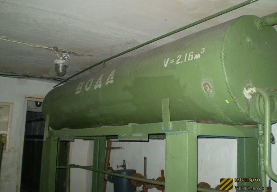
Бак аварийного запаса воды.
