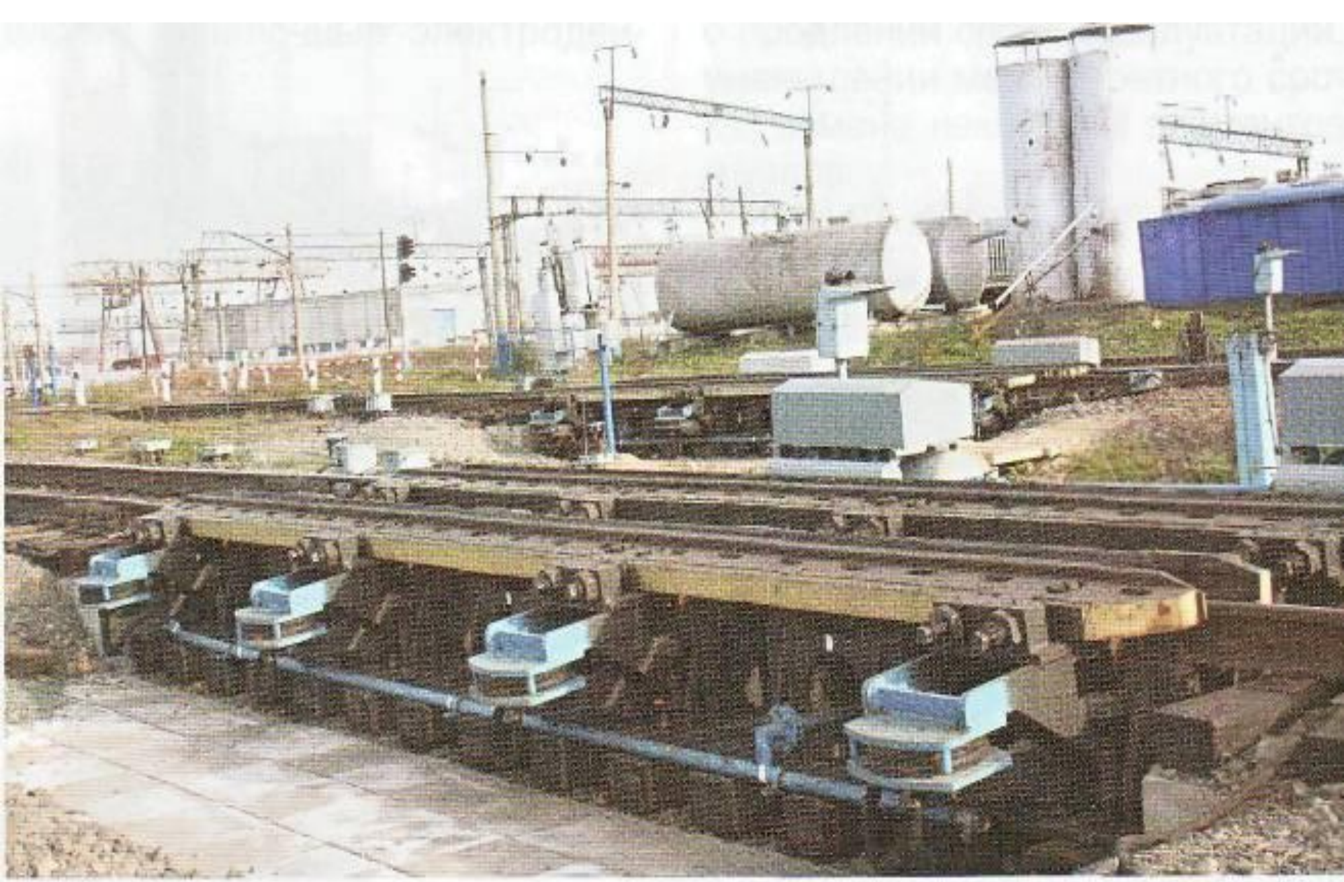
Замедлитель КНЗ-Зпк, установленный на первой тормозной позиции четной горки станции Тайшет
