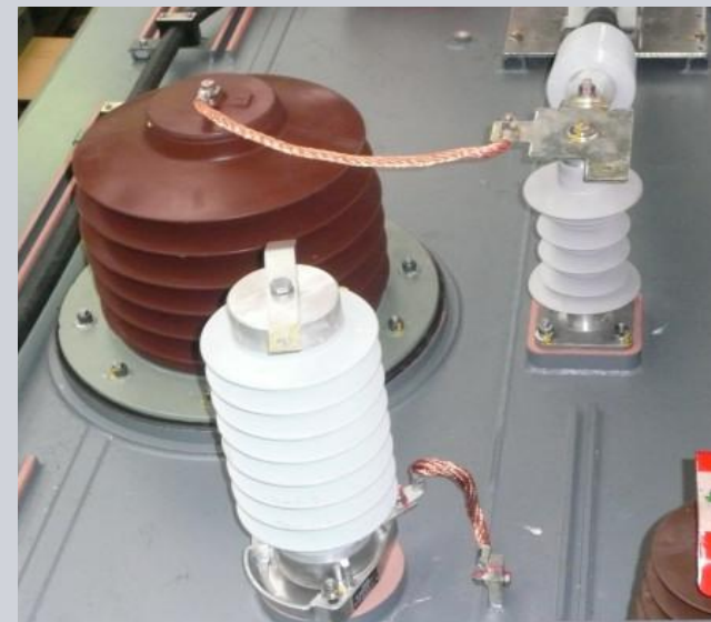
Сетевой трансформатор Разрядник защиты от перенапряжения
