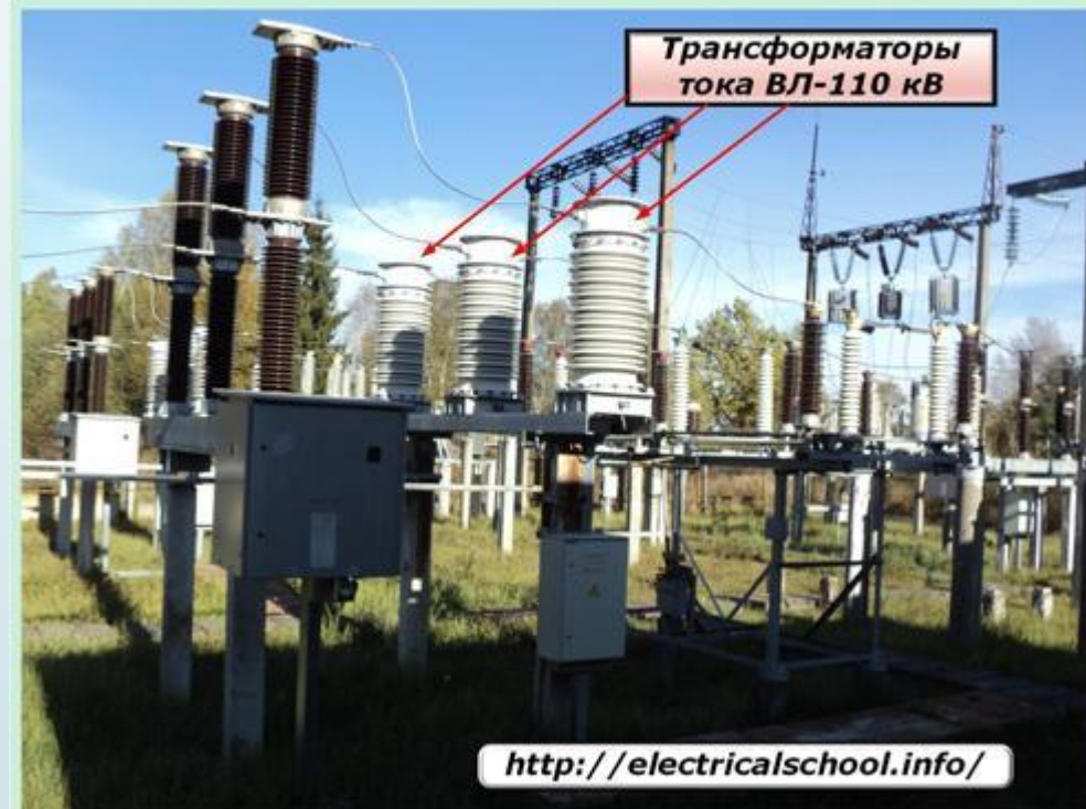
Трансформаторы тока ВЛ-110 кВ на подстанции 110/10кВ
