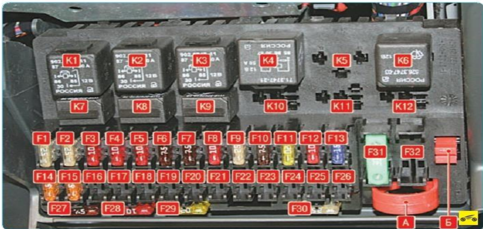
Рис. 10.2. Расположение реле и предохранителей в монтажном блоке: А, Б – пинцеты; К1 – реле включения электровентилятора радиатора системы охлаждения двигателя; К2 – реле включения обогрева заднего стекла; К3 – реле включения стартера; К4 – дополнительное реле (реле зажигания); К5 – место для резервного реле; К6 – реле включения омывателя и очистителя ветрового стекла; К7 – реле включения дальнего света фар; К8 – реле включения звукового сигнала; К9 – реле включения тревожного сигнала; К10, К11, К12 – места для резервного реле; F1–F32 – плавкие предохранители
