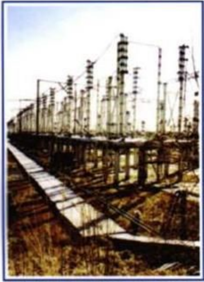
РУ с воздушными выключателями
