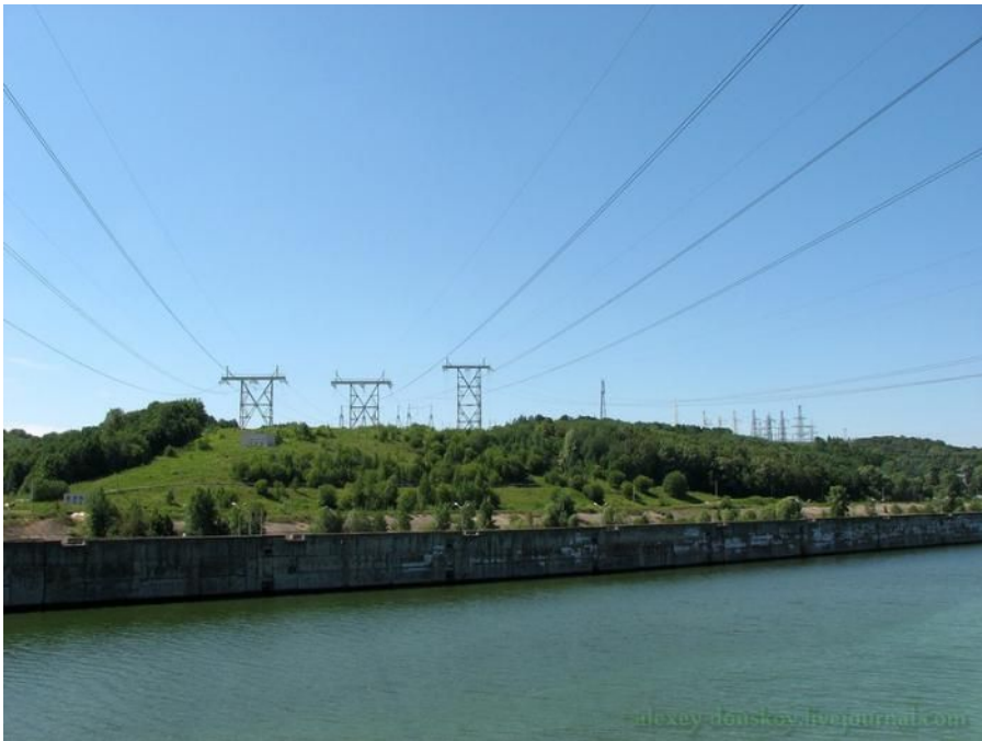
ЛЭП Чебоксарской ГЭС
