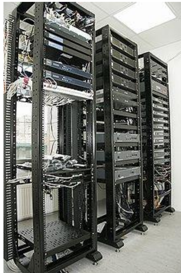
в – стойки с оборудованием
