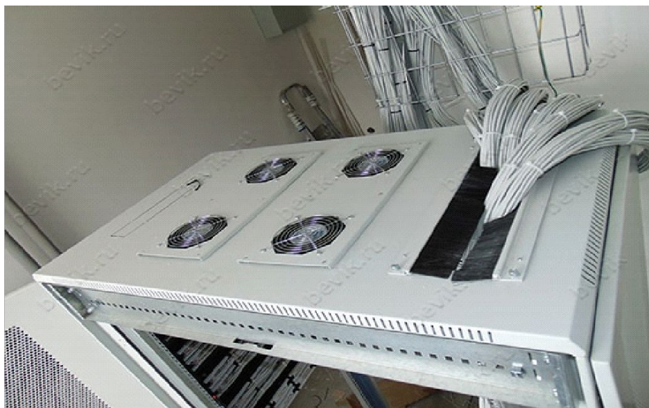
Рисунок 4. Щетки для кабельных вводов шкафов
