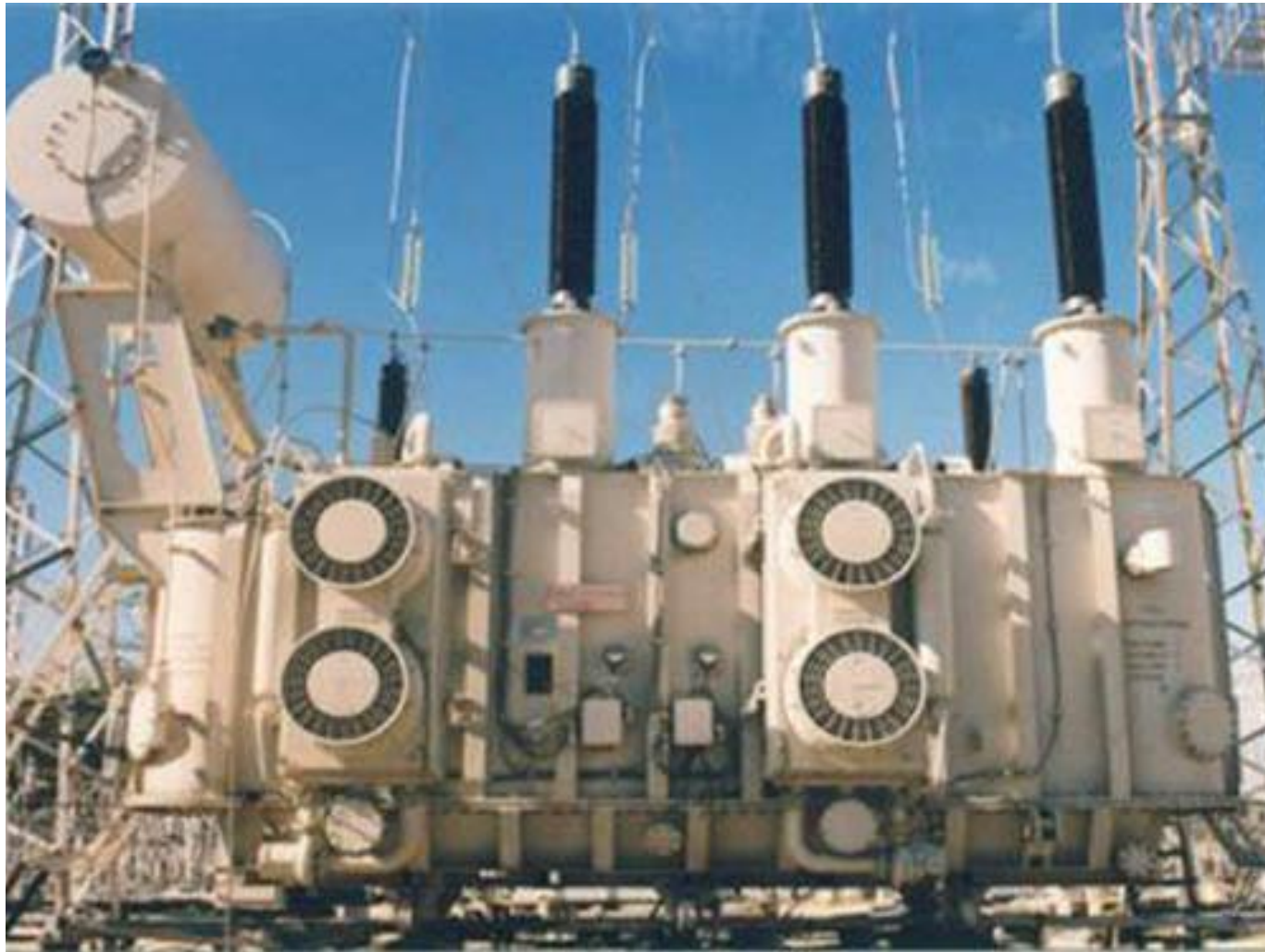
Трехфазный автотрансформатор 125МВА 220/110/10кВ
