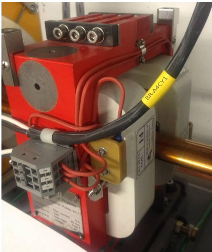
горизонтальный корректирующий магнит дипольный X корректор
