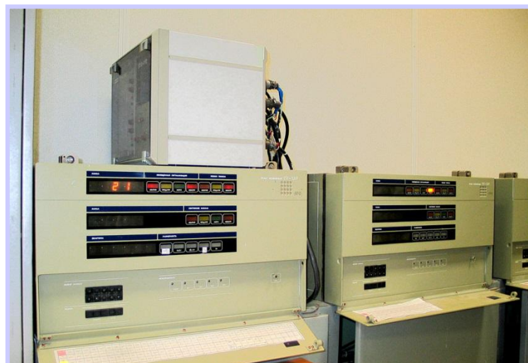
Оборудование системы АКРБ-08
