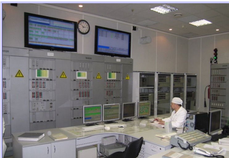
Центральный щит радиационного контроля
