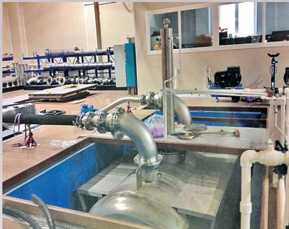
Измерительно-испытательный комплекс насосного оборудования
