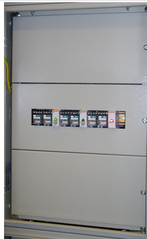
Щит управления АВР
