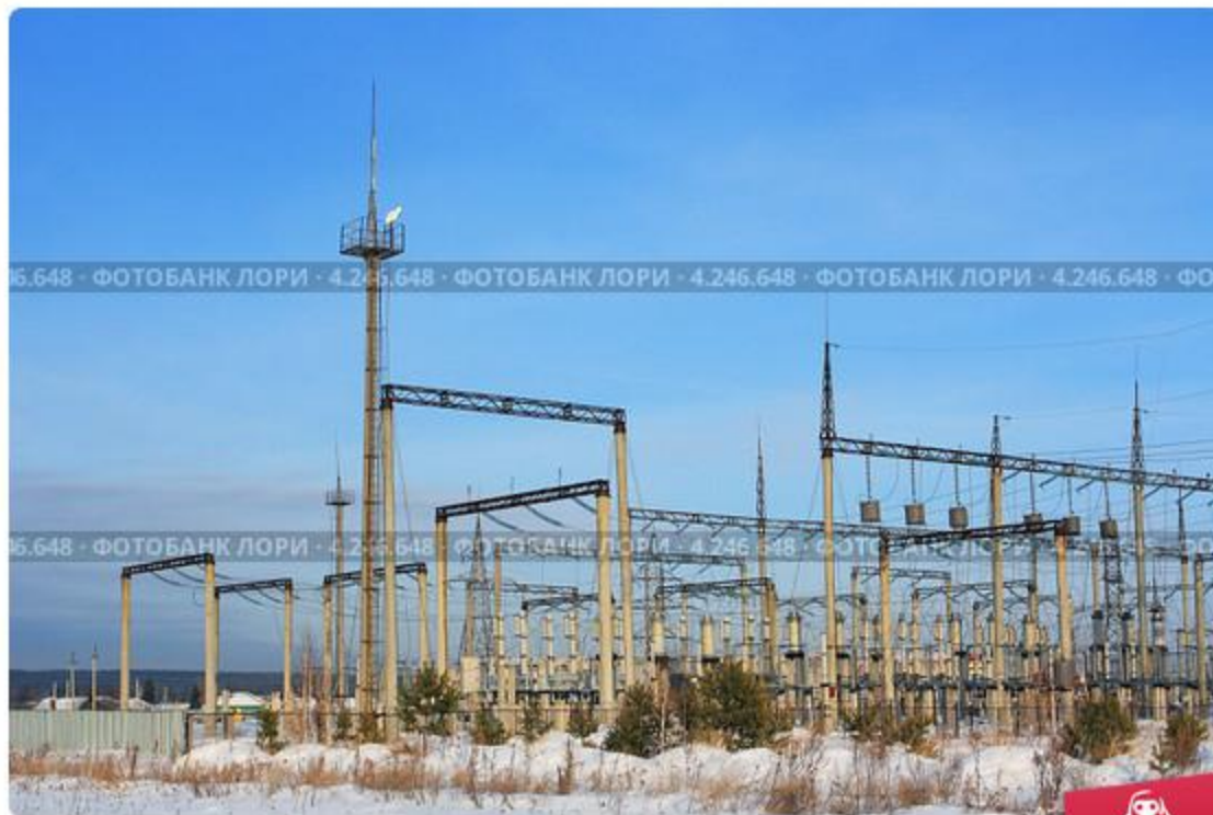
Подстанция с громоотводом © Анатолий Матвейчук / Фотобанк Лори
