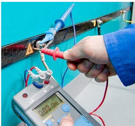
проверка сопротивления заземления;
