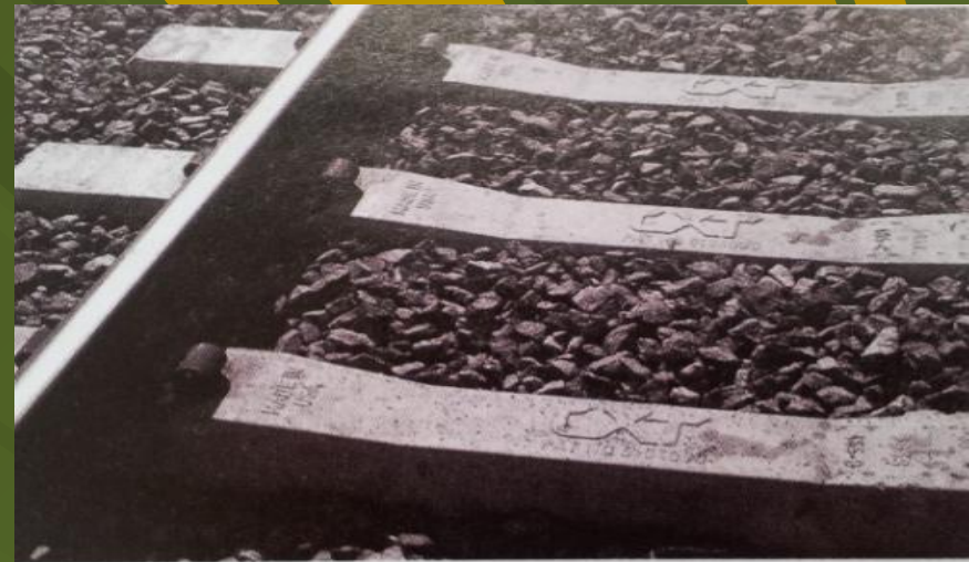
Рис. 1. Путь на железобетонных шпалах компании СХТ
