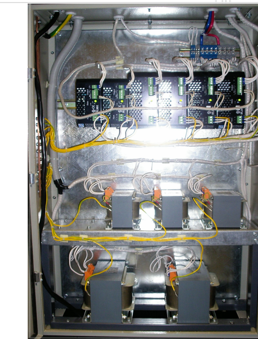
Отделение преобразователей и трансформаторов
