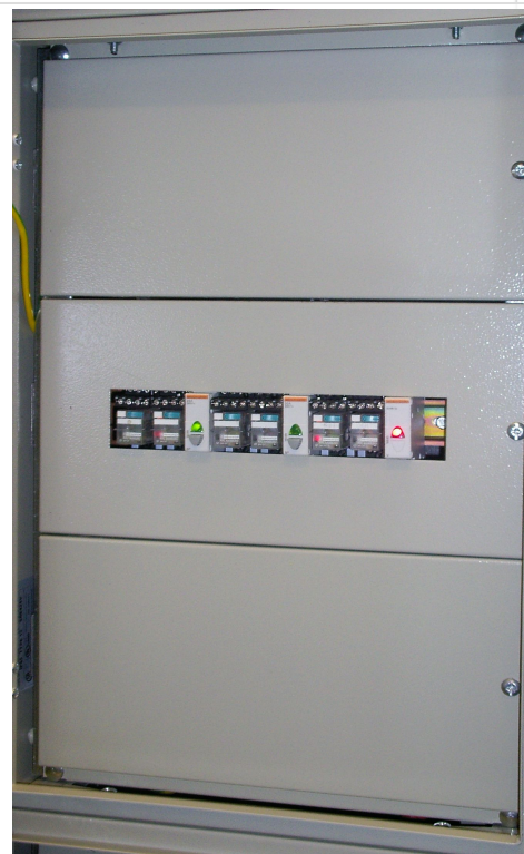
Щит управления АВР
