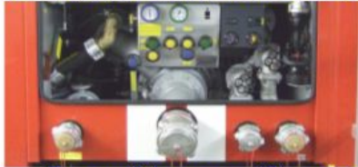
Водяной (пожарный) насос
