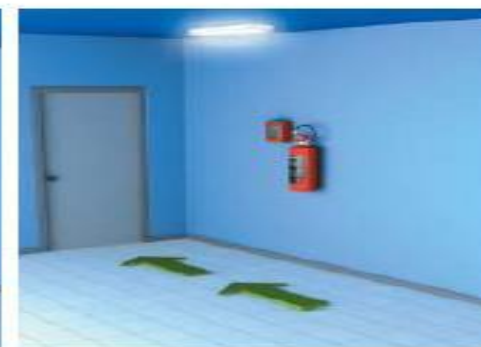
Возле каждой пожарной кнопки и огнетушителя.....
