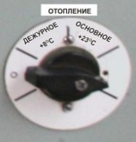
ОТОПЛЕНИЕ И ВЕНТИЛЯЦИЯ
