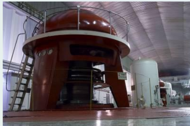
Машинный зал ГЭС
